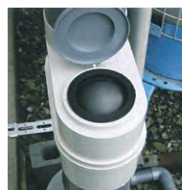
▲写真② フロートが上昇した状態
